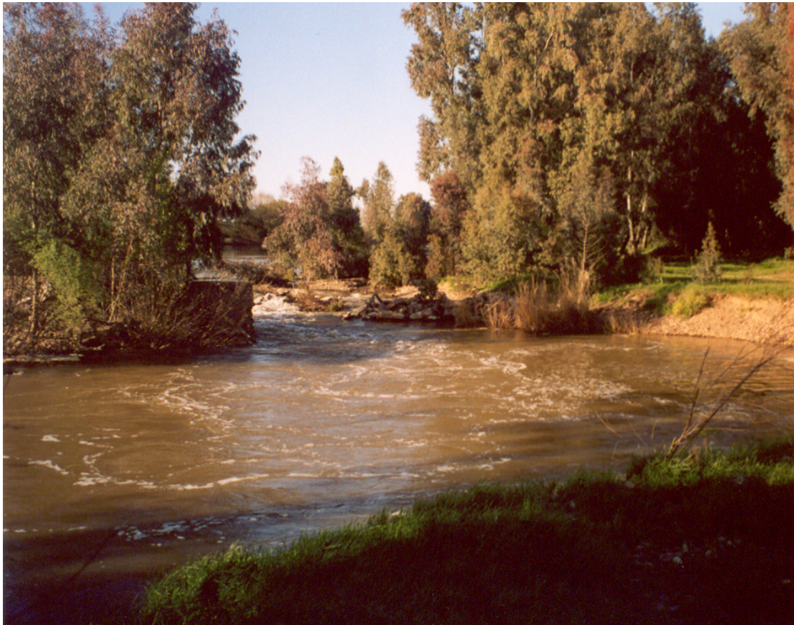
Figura A. 1 – Vista de jusante do rombo no descarregador de Monte da Vinha.
