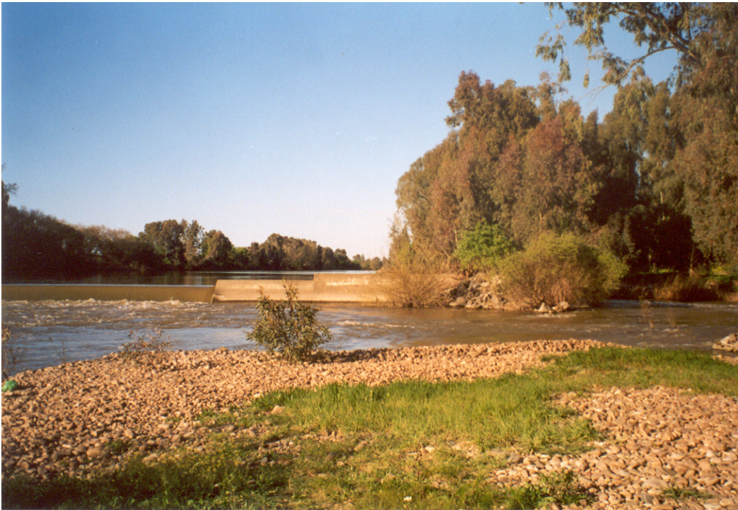
Figura A. 3 – Vista de jusante do rombo no descarregador de Monte da Vinha.
